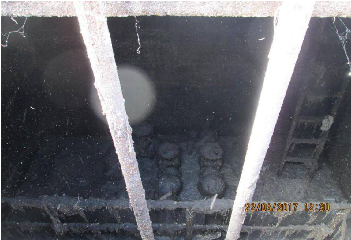
Zdjęcie 3 Widok wnętrza pompowni „Zastawie 2”
