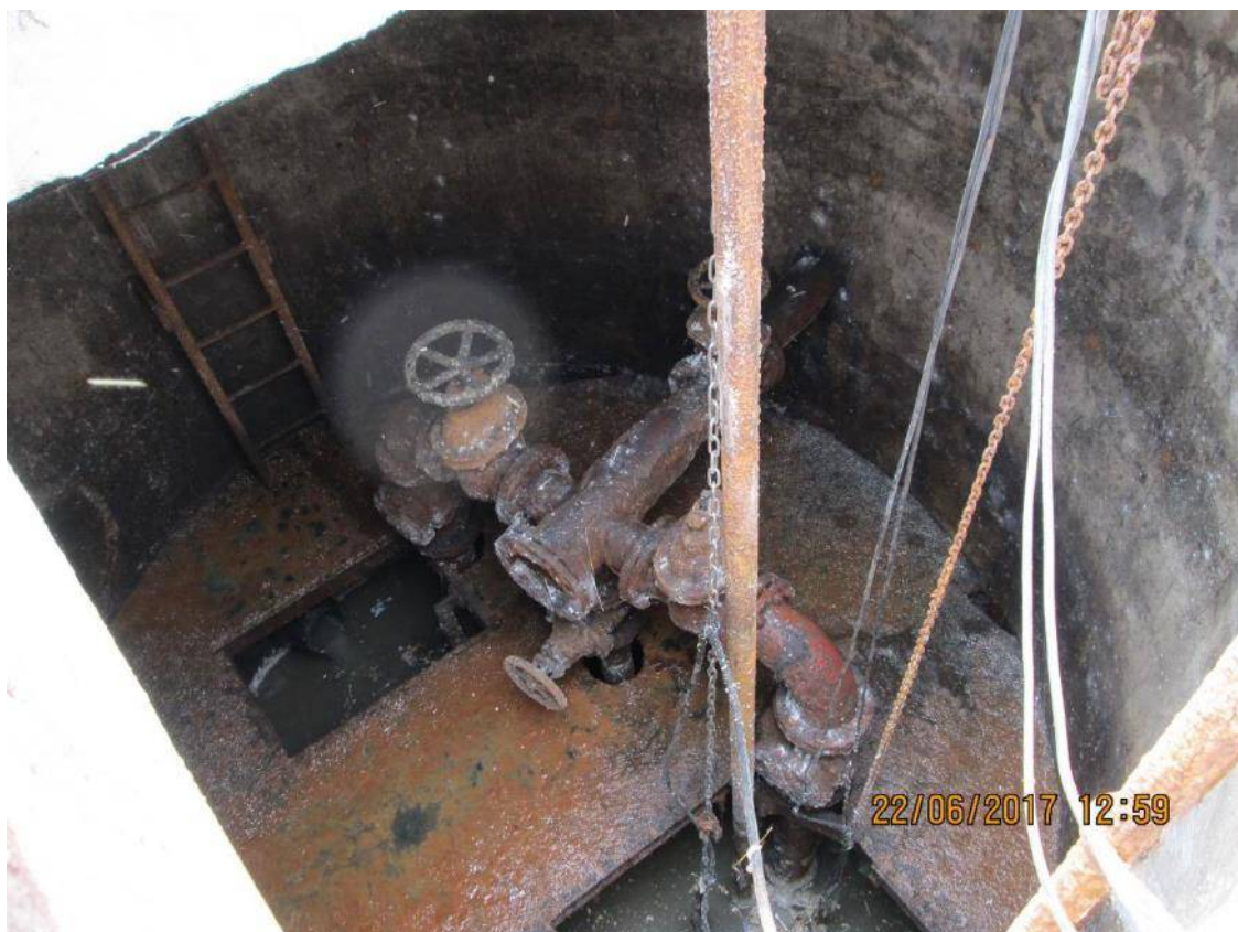
Zdjęcie 5Widok wnętrza pompowni ścieków „Morawica 1”
