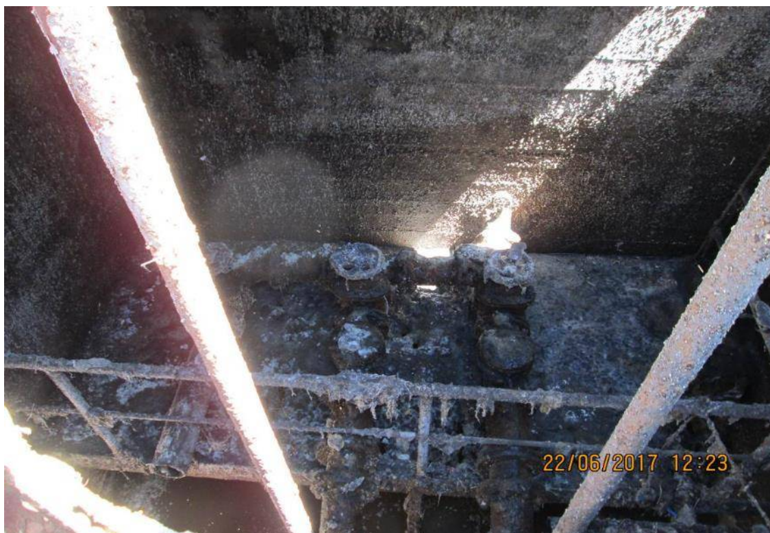
Zdjęcie 1Widok wnętrza pompowni „Zestawie 1”
