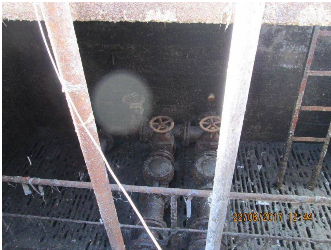
Zdjęcie 7Widok wnętrza pompowni ścieków „Bieleckie Młyny 1”
